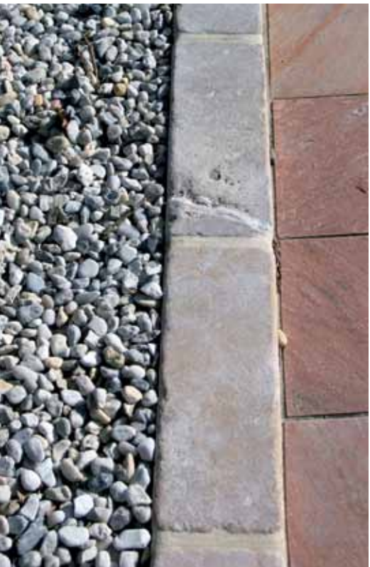
BORDURES CALCAIRE DU CAUSSE VIEILLIES
